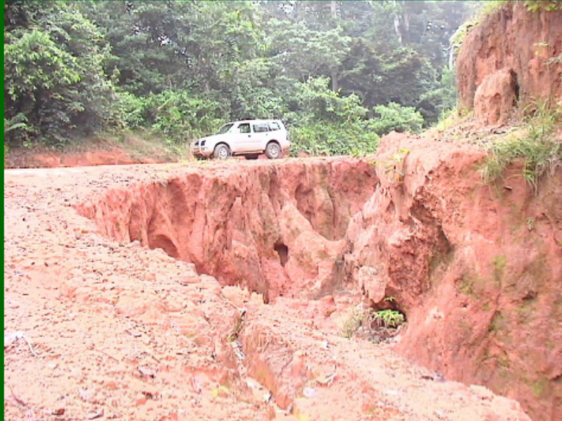
Erosion: mauvaise construction des routes
